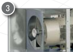
Turbina de refrigeración
